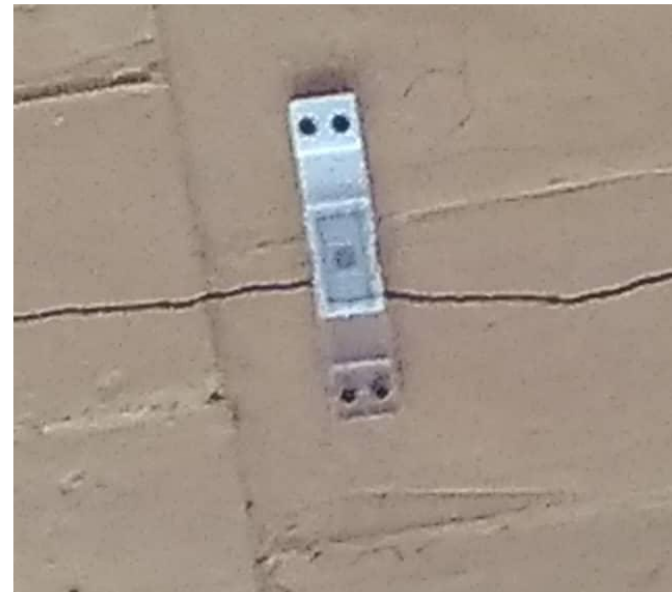
Fig 3. Fisurómetros colocados en: - Bloque 4 intradós del salón a la derecha, - Bloque 5 intradós de ambos salones.
