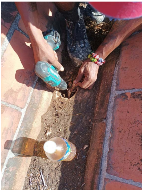
Radice profonda in una pluviale
