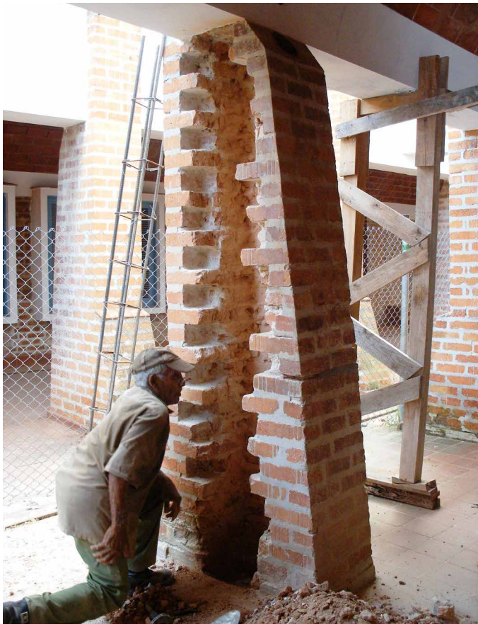
Fig. 30 Ejemplo de consolidación agresiva del contrafuerte. Inclusión de una columna de hormigón armado.
