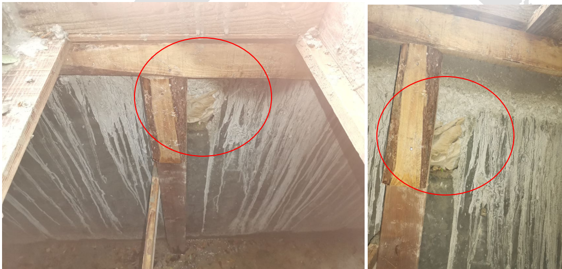
Img 1 y 2. Imágenes del pase interior de la entrada al tanque séptico.
